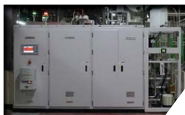
▲ DC ESS용 1MW
