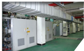
▲ Chlor-Alkali 제조공장 전원장치
